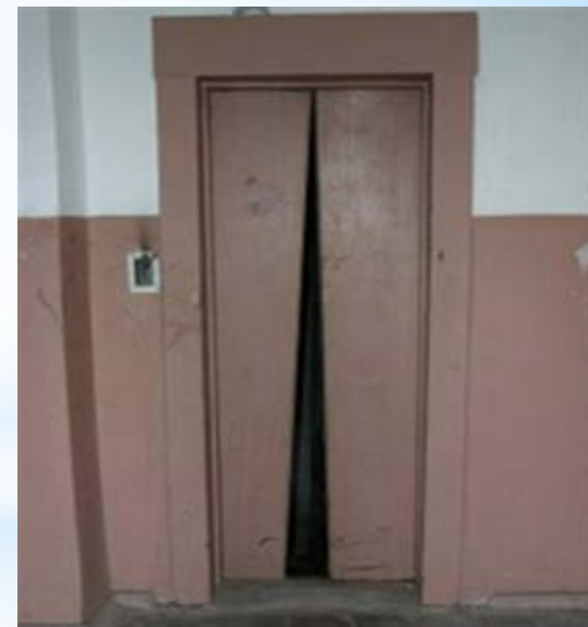
Неисправность лифтового оборудования
