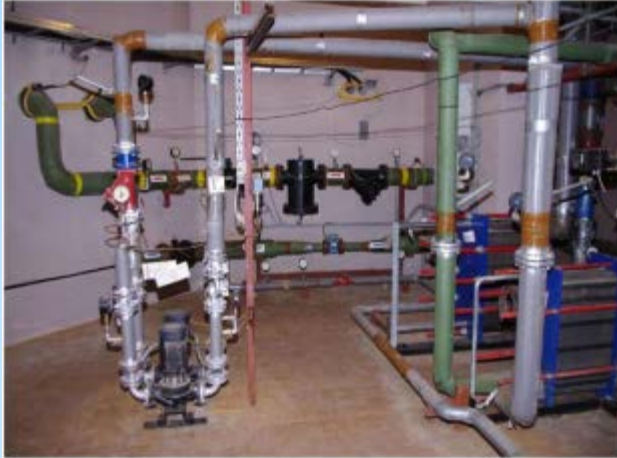
Система отопления, горячего и холодного водоснабжения
