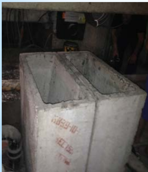
Отсутствуют предохранительные решетки на оголовках вентканалов
