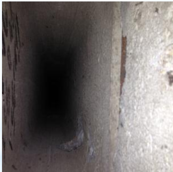
Негерметичность сборной вентиляционной шахты
