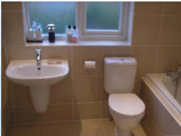
Система канализации и водоотведения
