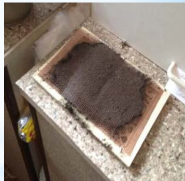
Загрязнение решетки вытяжного отверстия в квартире
